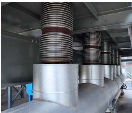
Pipe penetration seals installed in a HRSG system.
